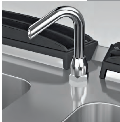
Carga de agua mediante electroválvula.
